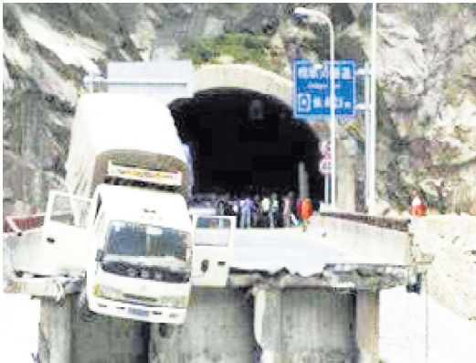
桥面坍塌见证史上最幸运司机。(公有领域)
